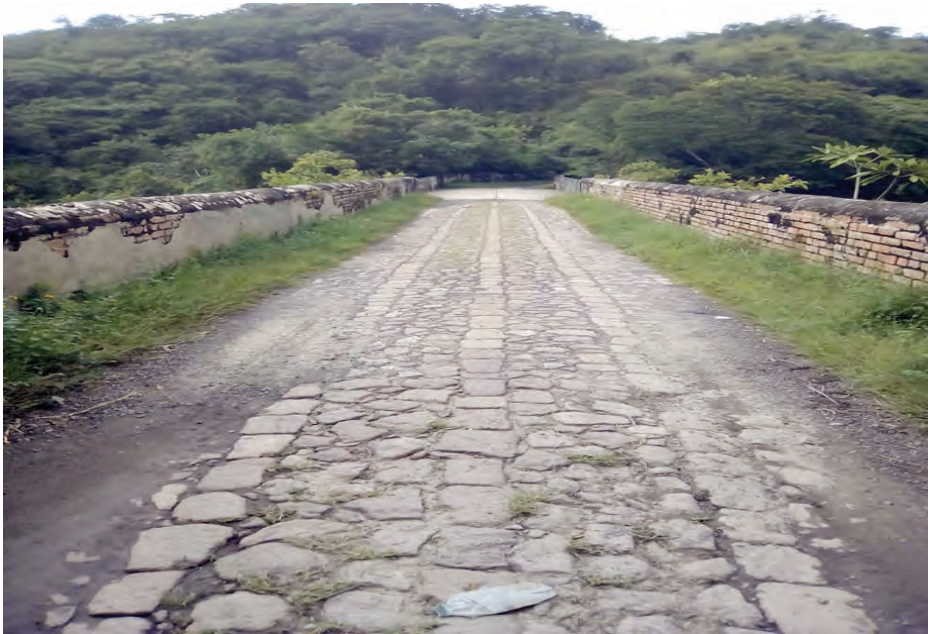
Detalle de la calzada del puente. Claramente se ve la falta de mantenimiento. La ineffectividad de los desagües por falta de mantenimiento retiene las aguas pluviales y la humedad en la calzada. Es evidente que a largo término minará la estructura del puente. Foto: Eduardo Rivas.
