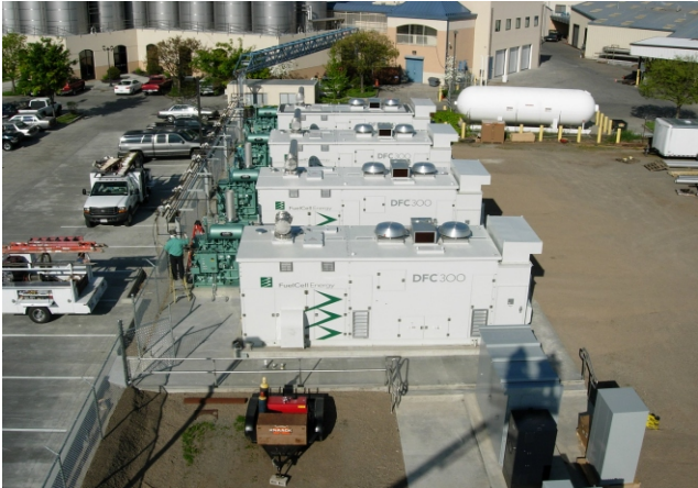
Fig. 7 Central de generación eléctrica DFC300MA
